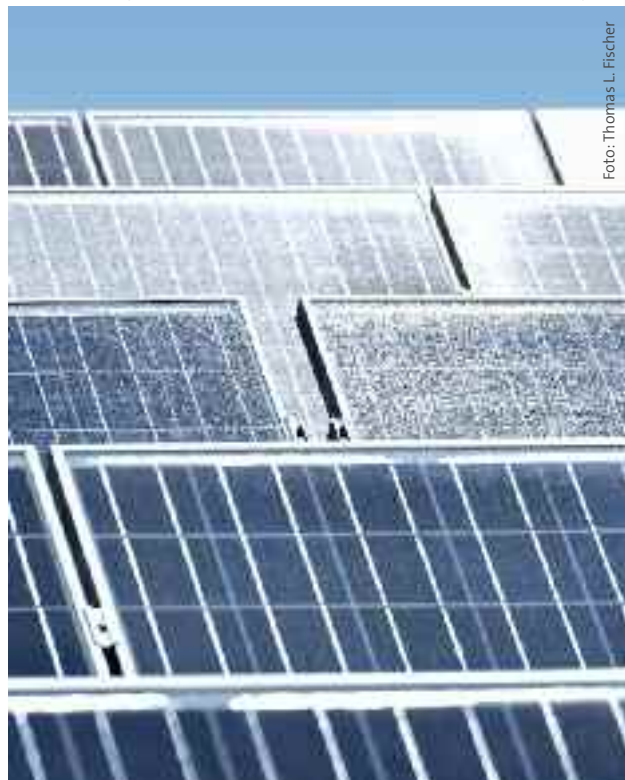
Photovoltaikanlage in Carlino (Italien), im Bestand des KGAL-Fonds „InfraClass Energie 5“
